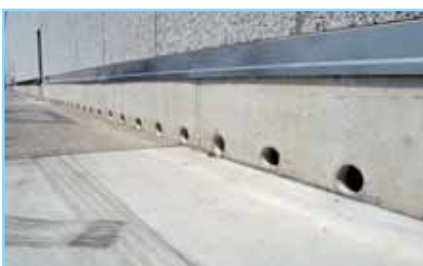
fig. 5) Ventilation externe adaptée - Trous 1 à peu près à chaque mètre.
